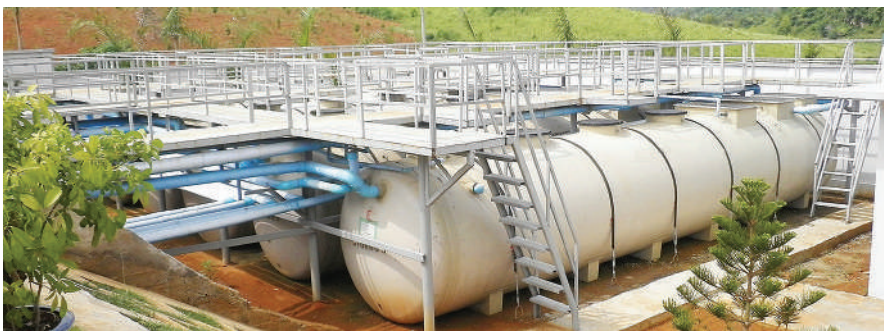
Рис. 44.6. Установки з очищення води закритого типу
